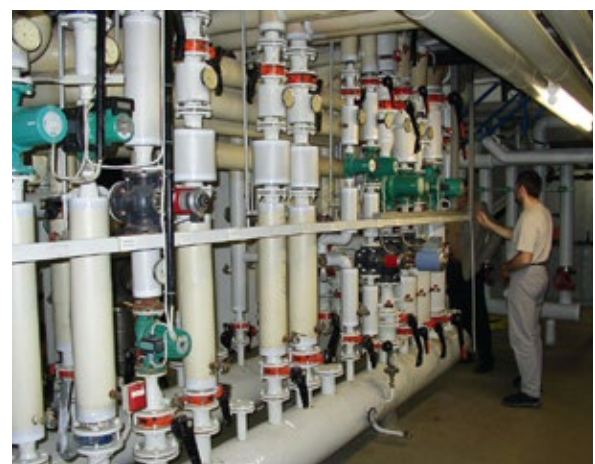
Technik Hallenbad Heddeshheim
